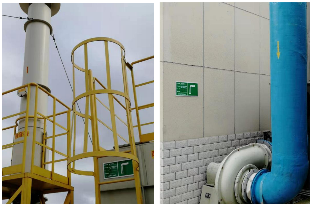
图 1 排气筒标识牌
