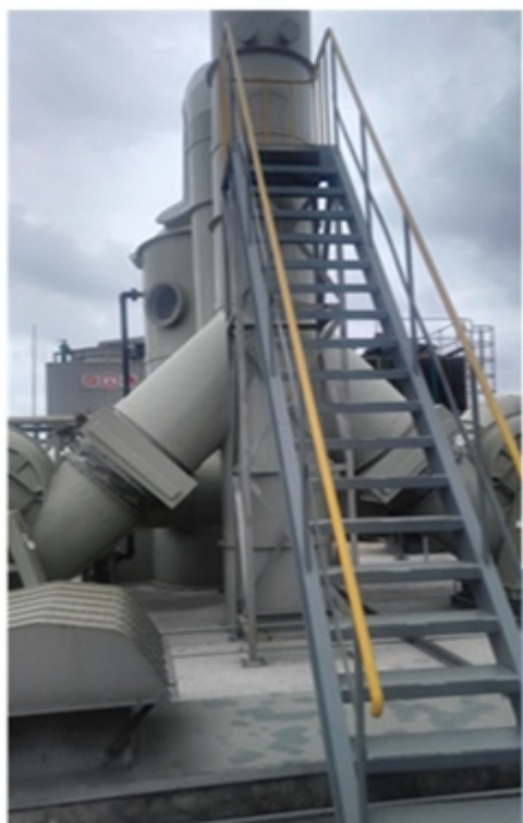
氨气尾气吸收装置
